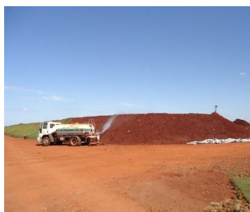
Figura 41. Caminhão pipa utilizado para irrigação dos taludes CRTR Ambiental Sul Doré Engenharia, 27/03/2014
