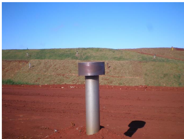
Detalhe do dreno e flare do aterro sanitário CRTR Ambiental Sul
