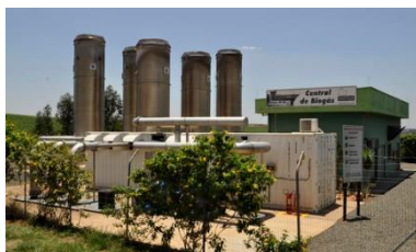
Figura 4. Central do Biogás
