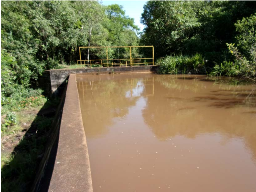
Figura 12 – Tomada d'água de Baixa Pressão Fonte: CS Ambiental, 2014.
