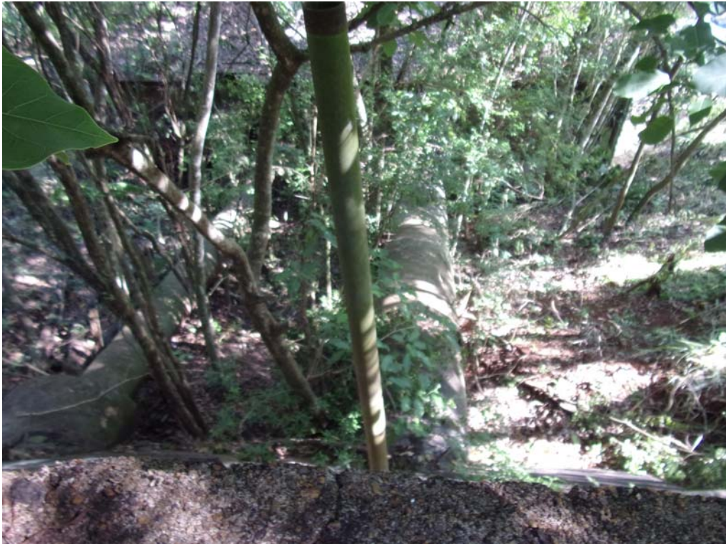
Figura 18 - Conduto forçado. Fonte: CS Ambiental, 2014.
