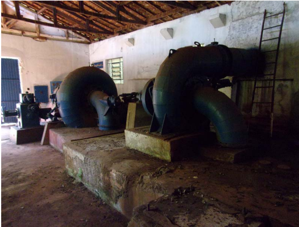
Figura 21 - Grupo gerador. Fonte: CS Ambiental, 2014.
