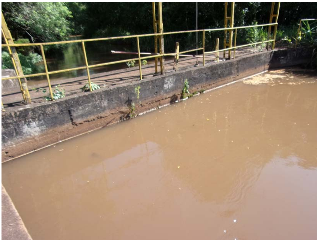
Figura 13 – Comportas de acesso ao canal de adução Fonte: CS Ambiental, 2014.
